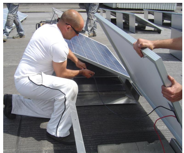
Figuur 8 Sluit de bekabeling aan op naast gelegen panelen zoals dit in het eendraadschema is opgegeven.
