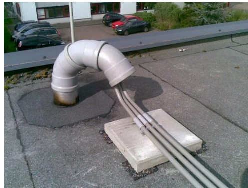
Figuur 9: Voorbeeld van kabeldoorvoer
