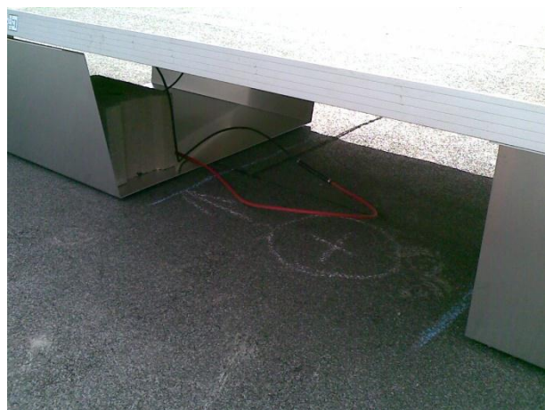
Figuur 12: Voorbeeld van een niet correcte afwerking voor wat betreft de bekabeling. Kabels mogen niet los op het dak liggen.
